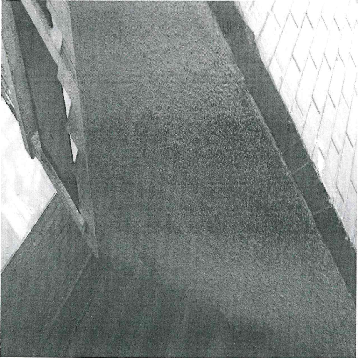
1. Vista da escada sem corrimão.
