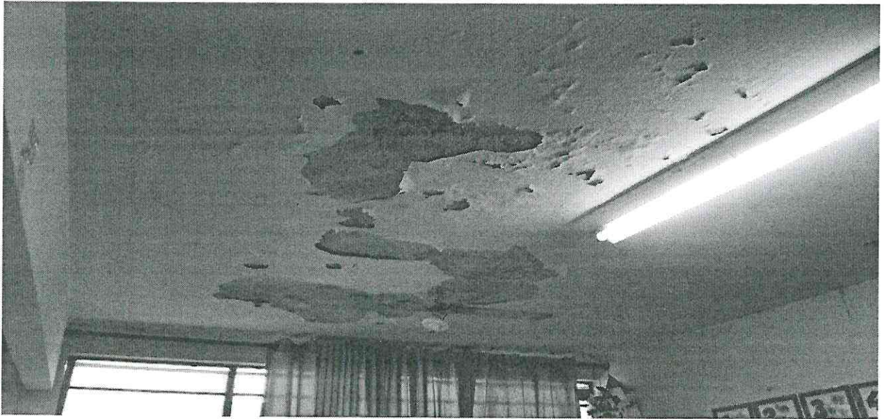
1. Infiltração no teto – vazamento do telhado danificado.
