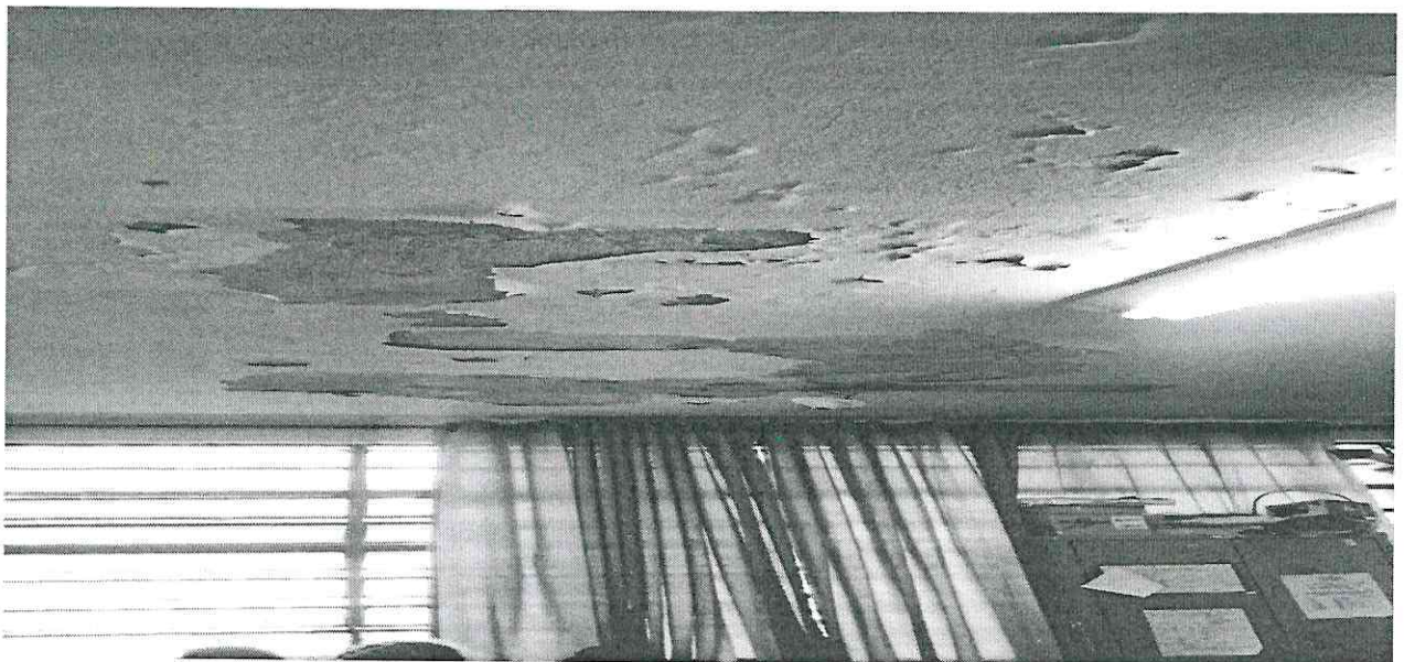
2. Infiltração e mofo – vazamento do telhado.
